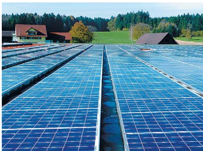
Die Solaranlage auf dem Dach der Pistor ist auch ökonomisch nachhaltig.
